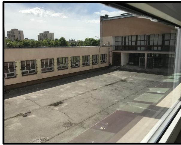
patio niezdatne do użycia
